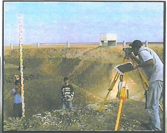
Implantation de l'ouvrage BRI-1/C10-6bis/OFPA-R4 (sept. 1999)
